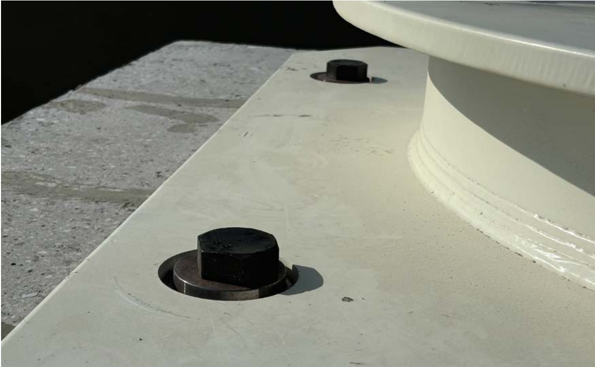
foto 1 Detailopname van een bout met verzonken onderleggingen; de excentriciteit ten opzichte van het gat is duidelijk te zien
