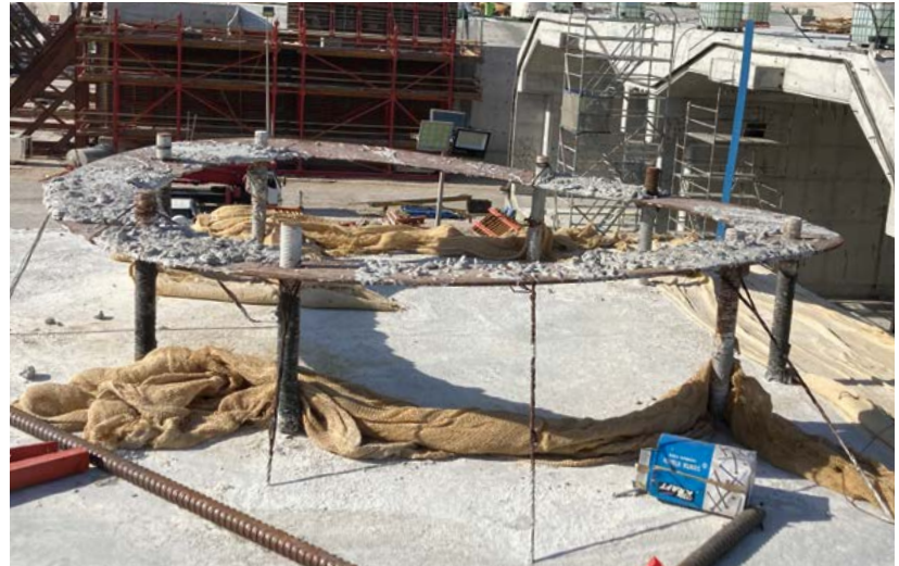
foto 5 Stalen mal ten behoeve van de plaatsing van de ankers, in dit geval van onvoldoende kwaliteit
