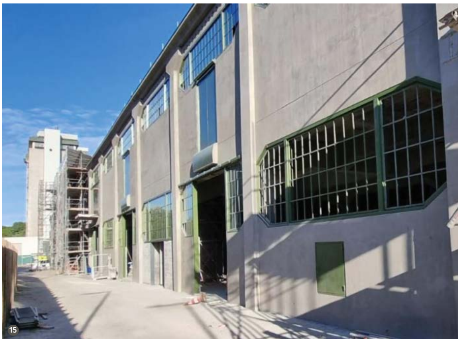
13 De betonconstructie aan de Veerlaan was in slechte staat
